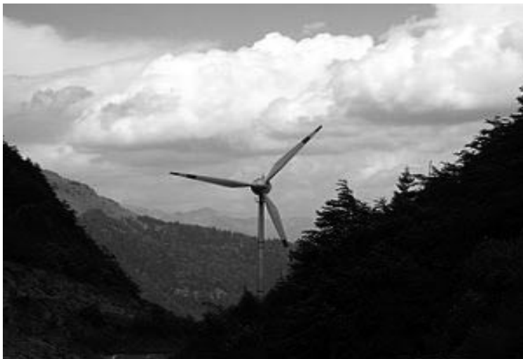
Αιολικός σταθμός στο Passo Monte Croce, σύνορα Αυστρίας-Ιταλίας
